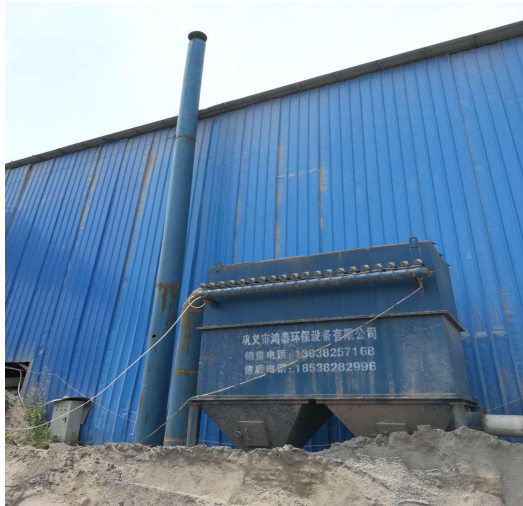
图 3-5: 布袋除尘器及排气筒
