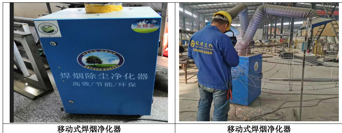
图3-2 废气治理措施现场照片
